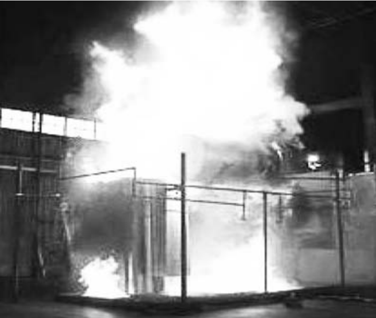
شکل ۱- ترانسفورماتور روغنی شعله ور شده
